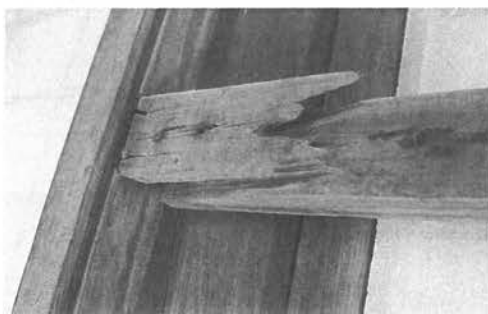
▲図15 現状 《鷹図》b、《鷹図》cの板戸の枠。鉄釘が錆により膨張し、木枠が破損している。
